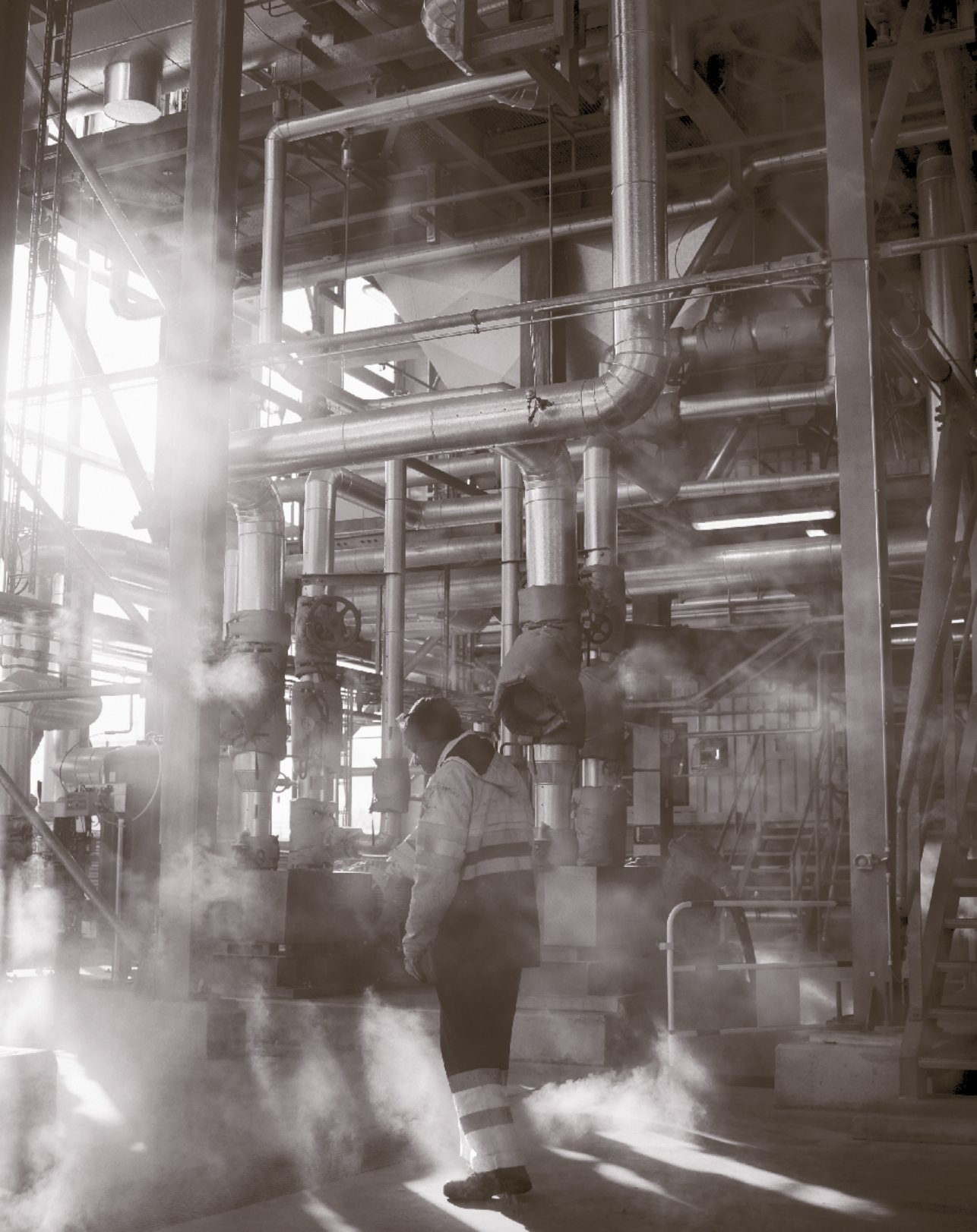
Stoom stijgt op uit de gloednieuwe bio-energiecentrale, direct naast de oude kolencentrale. Hier wordt 'laagwaardig' snoei- en afvalhout' verbrand.
